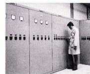
Steuerschränke für Sanitär- und Lüftungsanlagen im Hotel Zürich
