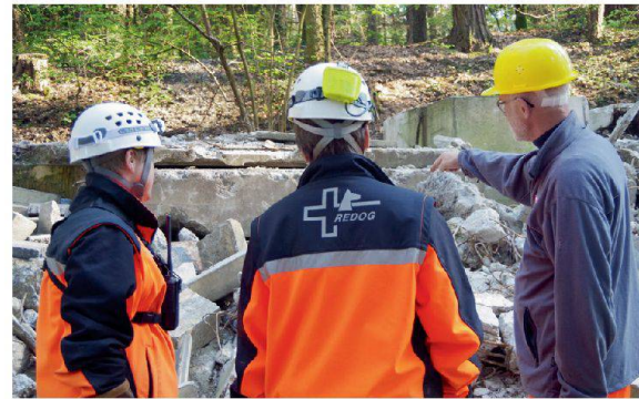
REDOG-Experten und ein Ingenieur bei der Raumerkundung auf dem Schadenplatz.
