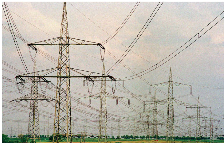
Die internationale Vernetzung stellt für kritische Infrastrukturen wie die Stromversorgung gleichzeitig ein Risiko und eine Chance dar.
