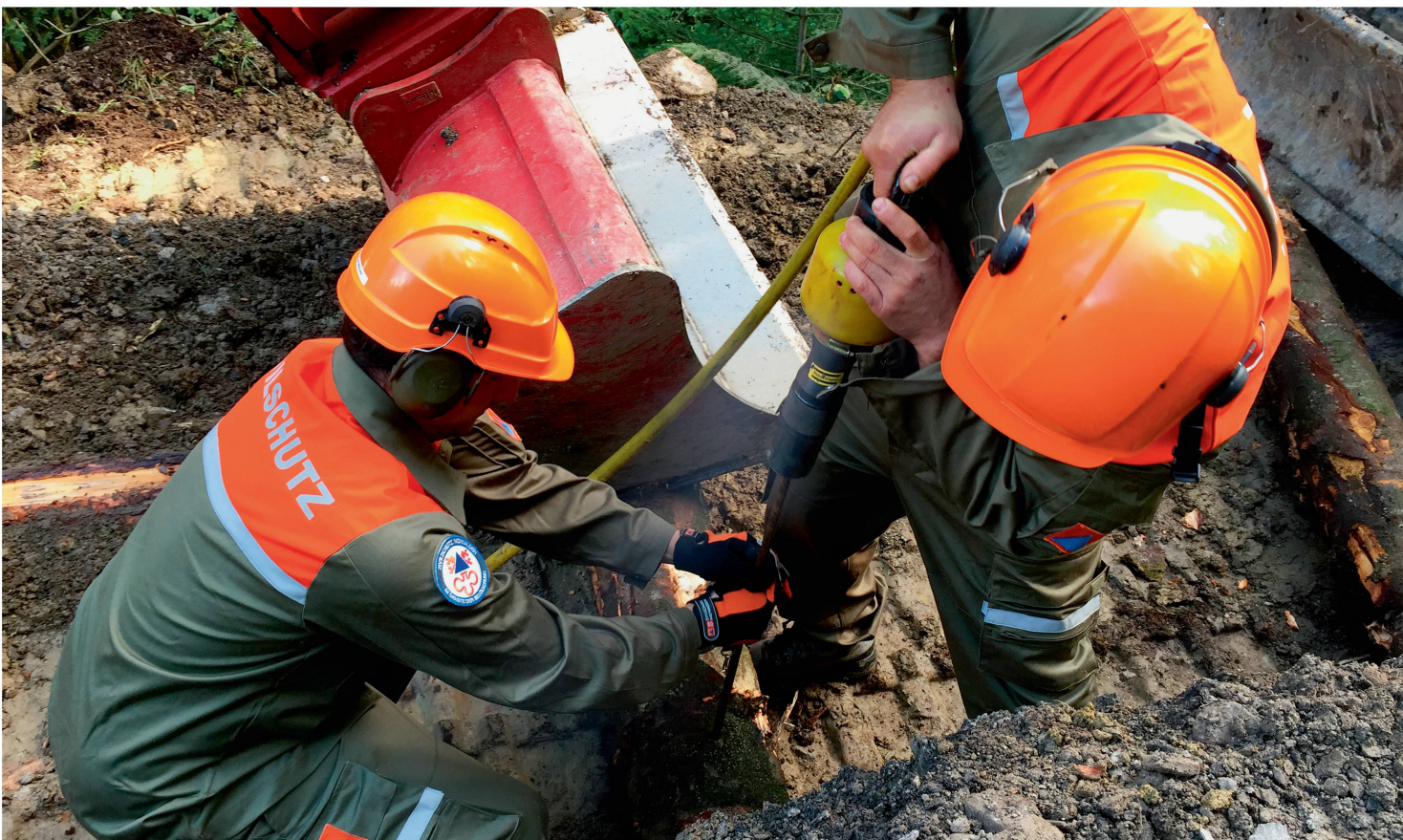
Instandstellungsarbeiten sollen neu als Ausbildung gelten und als Wiederholungskurse geleistet werden. Im Bild: Pioniere der Zivilschutzorganisation Nidwalden verschrauben Holzstämmen mit Armierungsseisen.
