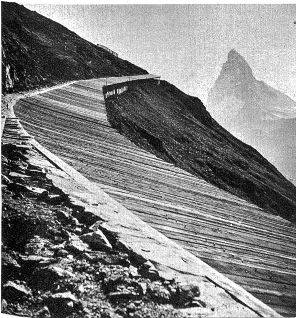
Blick auf die 770 m lange Lawinenschutzgalerie der Gornergratbahn bei Riffelberg (2585 m); im Hintergrund das Matterhorn.
