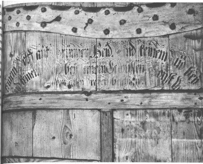
Kalchstätten: Tennstor mit Spruch. Durch die Erhöhung des Tores wurde der Spruch teilweise verdeckt. (Siehe Textteil)
