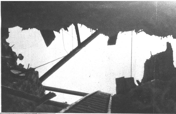
Rechts: Ausblick aus der Tiefe des Reparaturstollens. Das ist alles, was die Arbeiter tagsüber sehen
