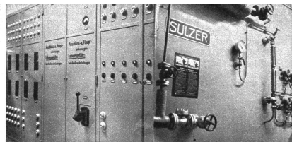
Elektro-Dampfkessel mit Verteilerraum und Kondensgefäss
