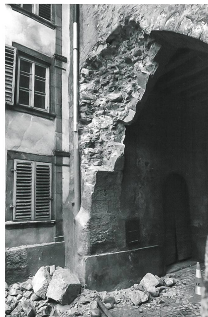
Fig. 6 Estavayer-le-Lac/Porte des Dominicaines. Arcade accidentée côté ville, le 2 juillet 2012
