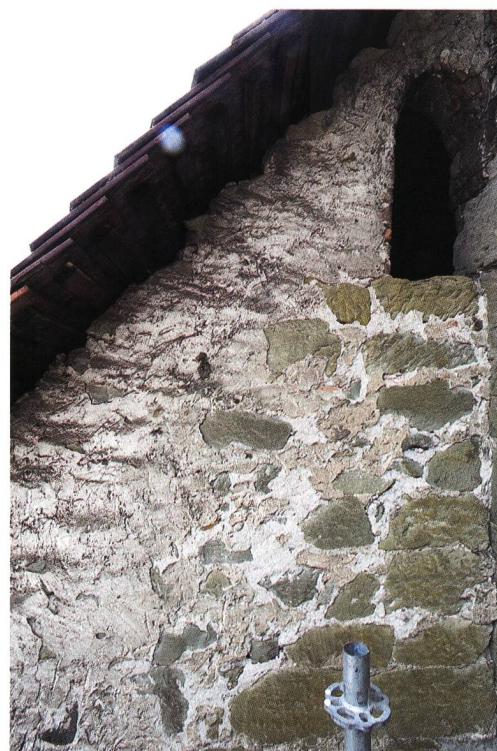
Fig. / Abb. 10 Aile orientale, détail du mur pignon nord avec la trace de la toiture médiévale Ostflügel, Detail des nördlichen Giebels mit Spuren der mittelalterlichen Bedachung
