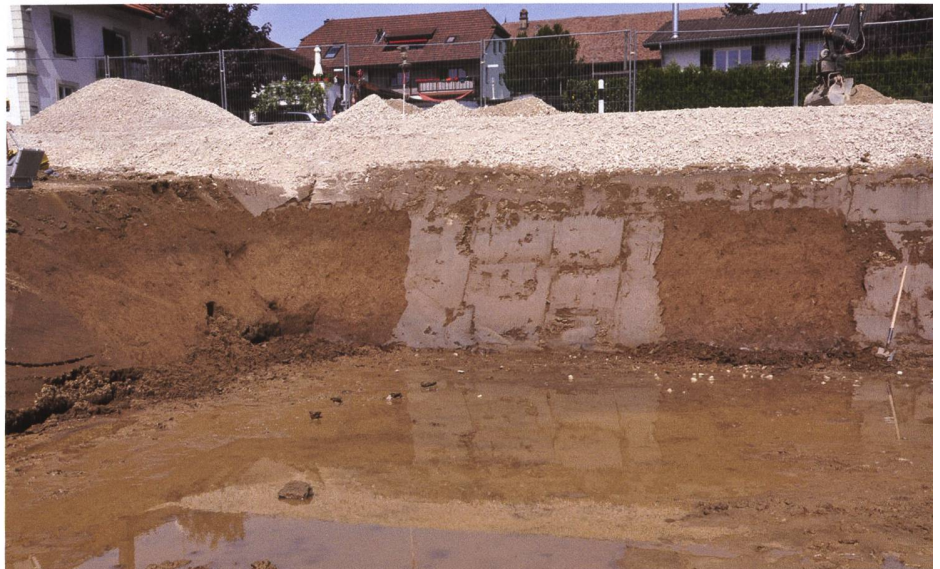
Fig. 25 Saint-Aubin/Sous la Rochetta, vue du site durant le suivi des travaux de 2015
