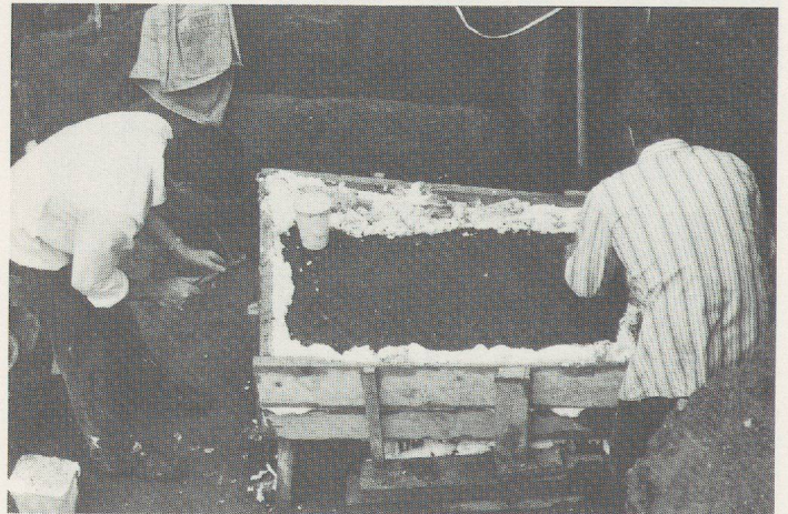
Fig. 11 Corseaux «en-Seyton». Coulage de la mousse de polyuréthane expansée; des interstices ont été aménagés pour faciliter le durcissement et laisser s'écouler le surplus.
