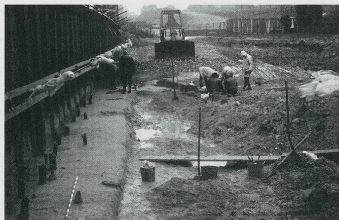
Fig. 3. Vue générale de l'extrémité ouest de la zone 1 en octobre 1996. Sur la gauche les palplanches destinées à soutenir l'ancienne voie ; contre ces dernières la fouille d'une banquette témoin (secteurs 41 à 43) sur laquelle on distingue les pieux de la palissade externe du village Bronze ancien E12 qui sont implantés dans des sables stériles.
