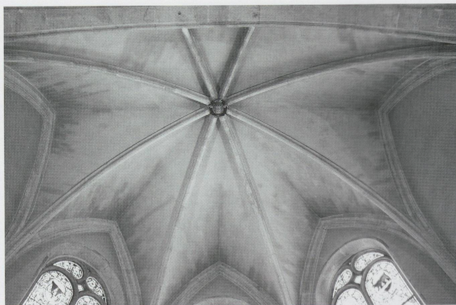
Fig. 630. La paroissiale de Môtiers au Val-de-Travers. La croisée d'ogives du sanctuaire, remontée vers 1680 apparemment selon le tracé de 1485, avec prolongation des nervures de l'abside jusqu'au doubleau, en partie au moyen d'éléments déjà taillés (photo MG, 2013).
