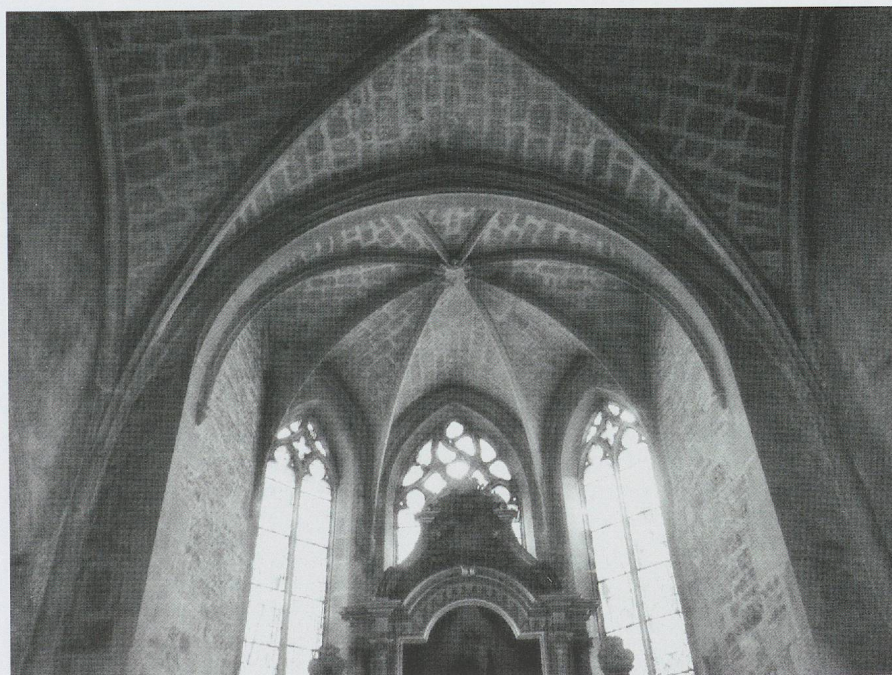
Fig. 599. L'église Saint-Georges du Bizot, 1503. La voûte du chœur avec les nervures rejoignant le doubleau (photo MG, 2011).
