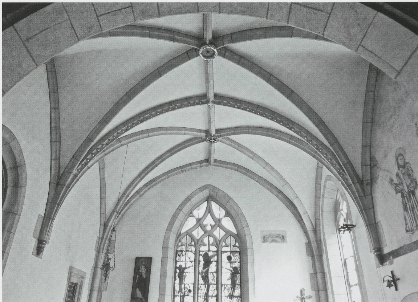
Fig. 717. L'église Saint-Pierre de Carignan. La voûte du chœur de 1512/1515, avec liernes faîtières et avec doubleau aux gorges décorées de billettes (photo MG, 2011).
