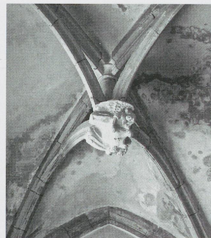
Fig. 1068. L'église de La Rivière-Drugeon. Clef pendante de la chapelle sud, attribuable à Antoine Lagniaz (photo MG, 2010).
