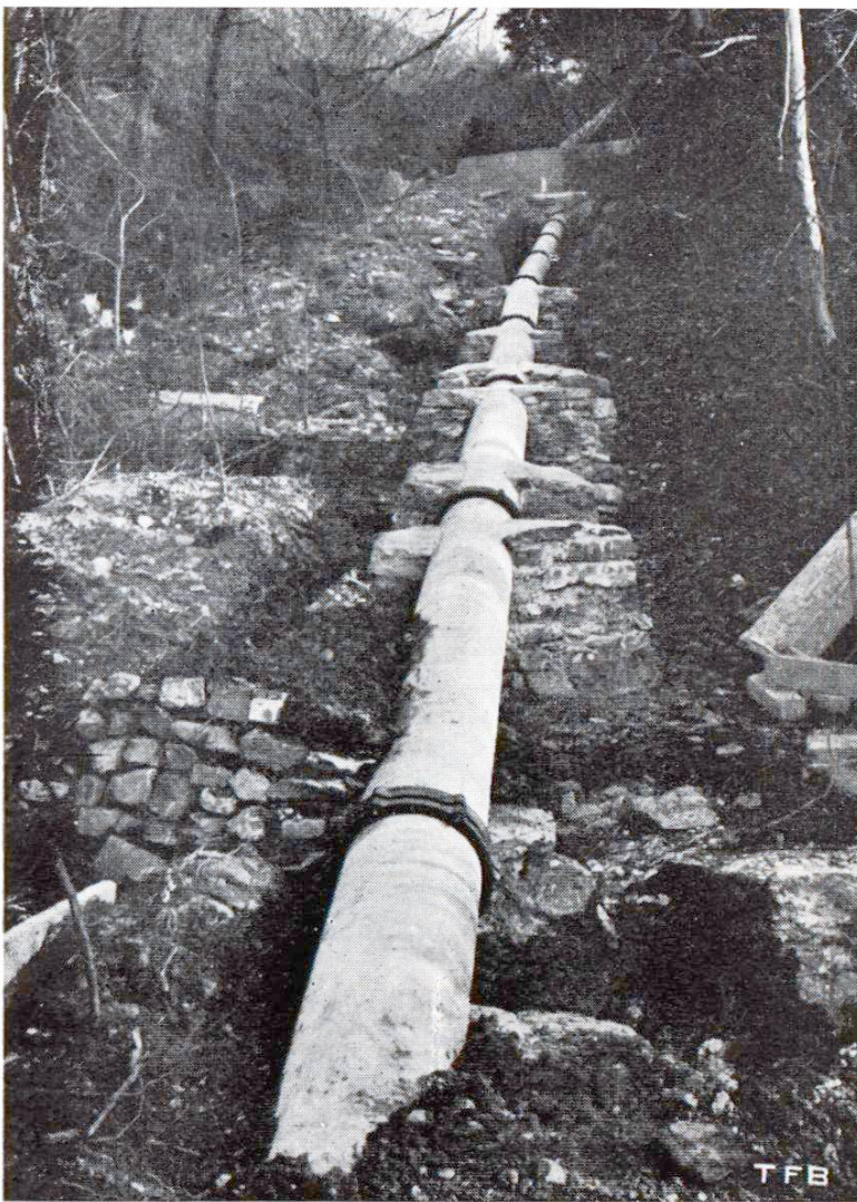
Fig. 2 Turbinenleitung in Eternit- Druckrohren von 400 mm \varnothing und einem Prüfdruck von 18 Atm.
