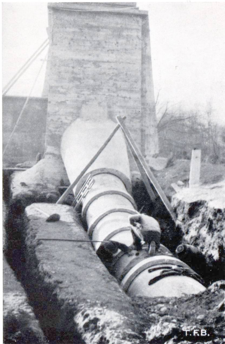
Abb. 2 Anschluss einer Druckleitung an Wasserschloss, 125 cm Durchmesser
