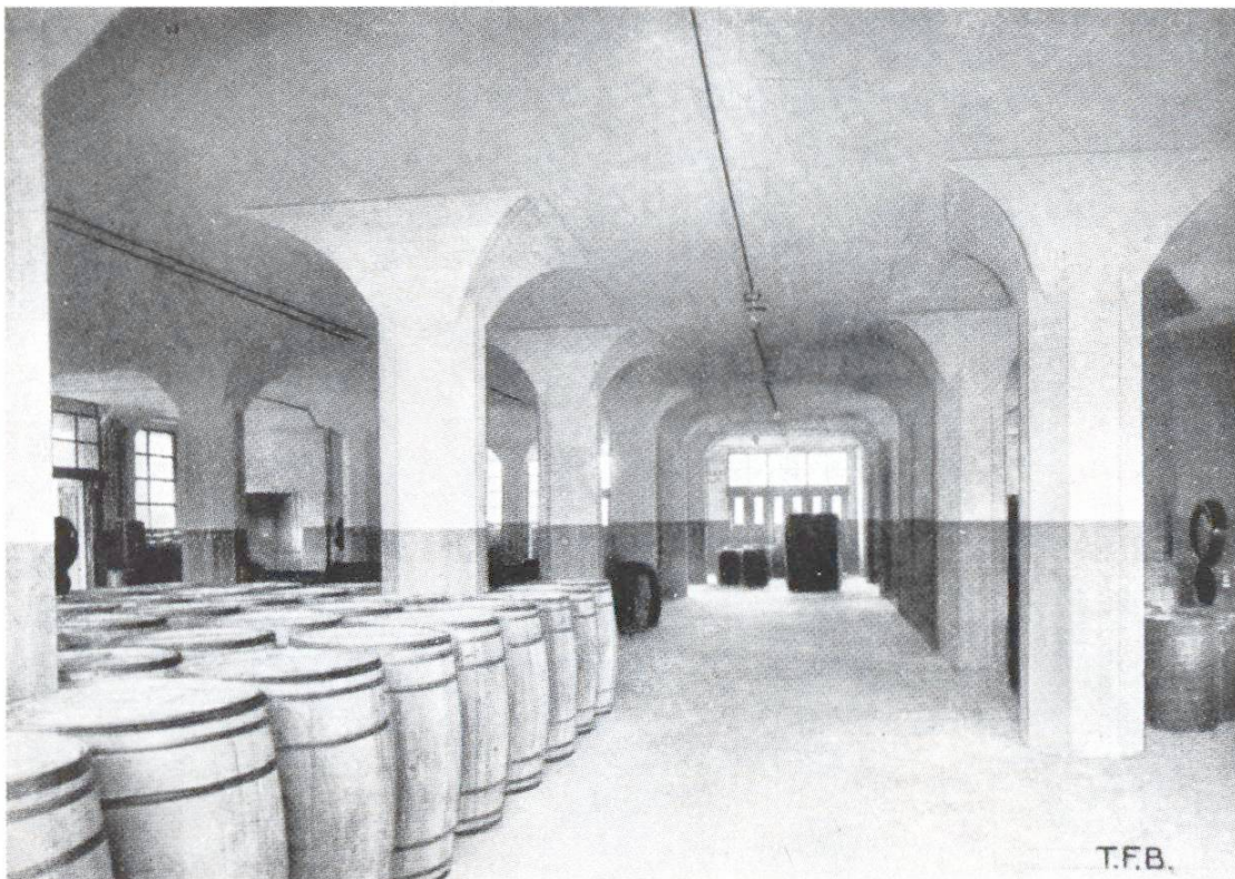
Abb. 7 Pilzdecke in Lagerhaus einer chemischen Fabrik
