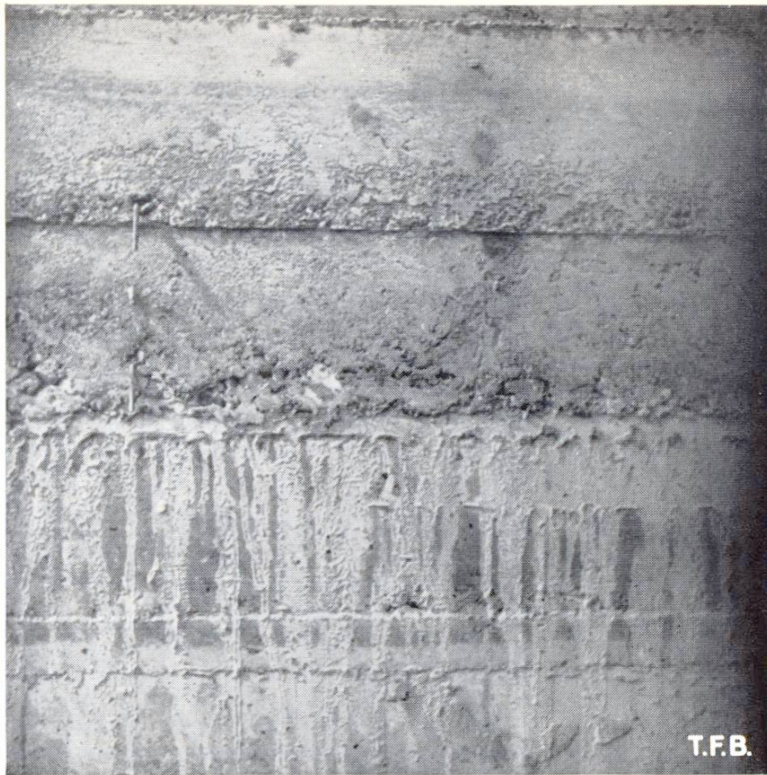
Abb. 3 An den Arbeitsfugen besteht die Gefahr des Bindemittelverlustes, wenn, wie in diesem Beispiel, die neue Schalung am alten Beton nicht gut anschliesst. Da gerade die Arbeitsfugen einen heiklen Punkt des Betonbaues darstellen, müssen kleine Fehler dieser Art vermieden werden
