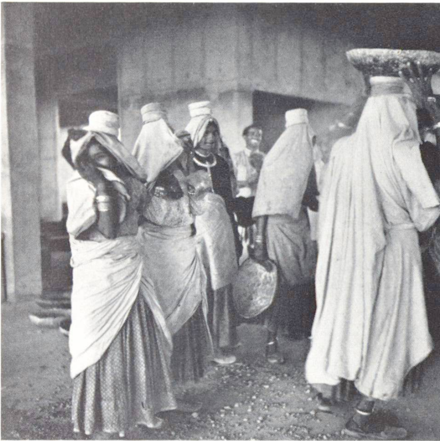
Abb. 3 Arbeiterinnen; in flachen Blechschalen tragen die Frauen den Beton auf dem Kopf zur Stelle der Verarbeitung
