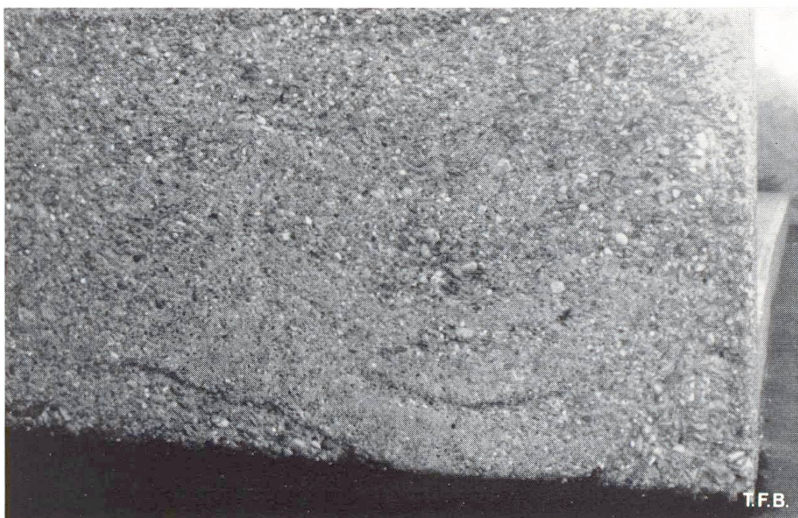
Abb. 6 Am Fuße dieser Mauer sind die typischen Entmischungserscheinungen infolge fehlerhaftem Einbringen verewigt. Beim Waschbeton lassen sich solche Fehler nicht mehr korrigieren.
