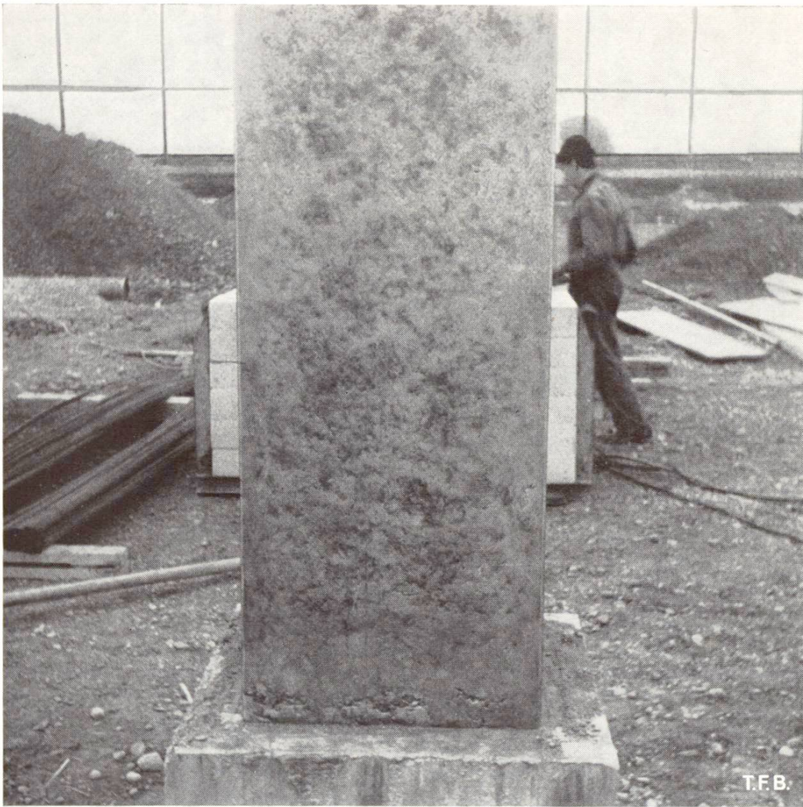
Abb. 5 Spuren der leichten Zementleimentmischung und der Reibung zwischen Schalung und Beton beim Nachsetzen.
