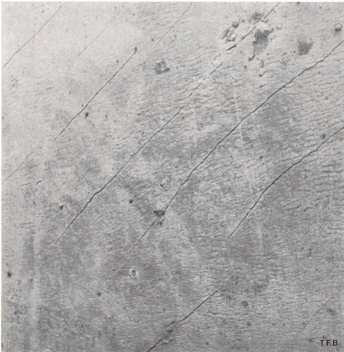
Abb. 3 Fröhschwindrisse in einem Hofbelag, der mit dünnflüssigem Beton P 350 und bei kühler und trockener Witterung hergestellt worden ist.
