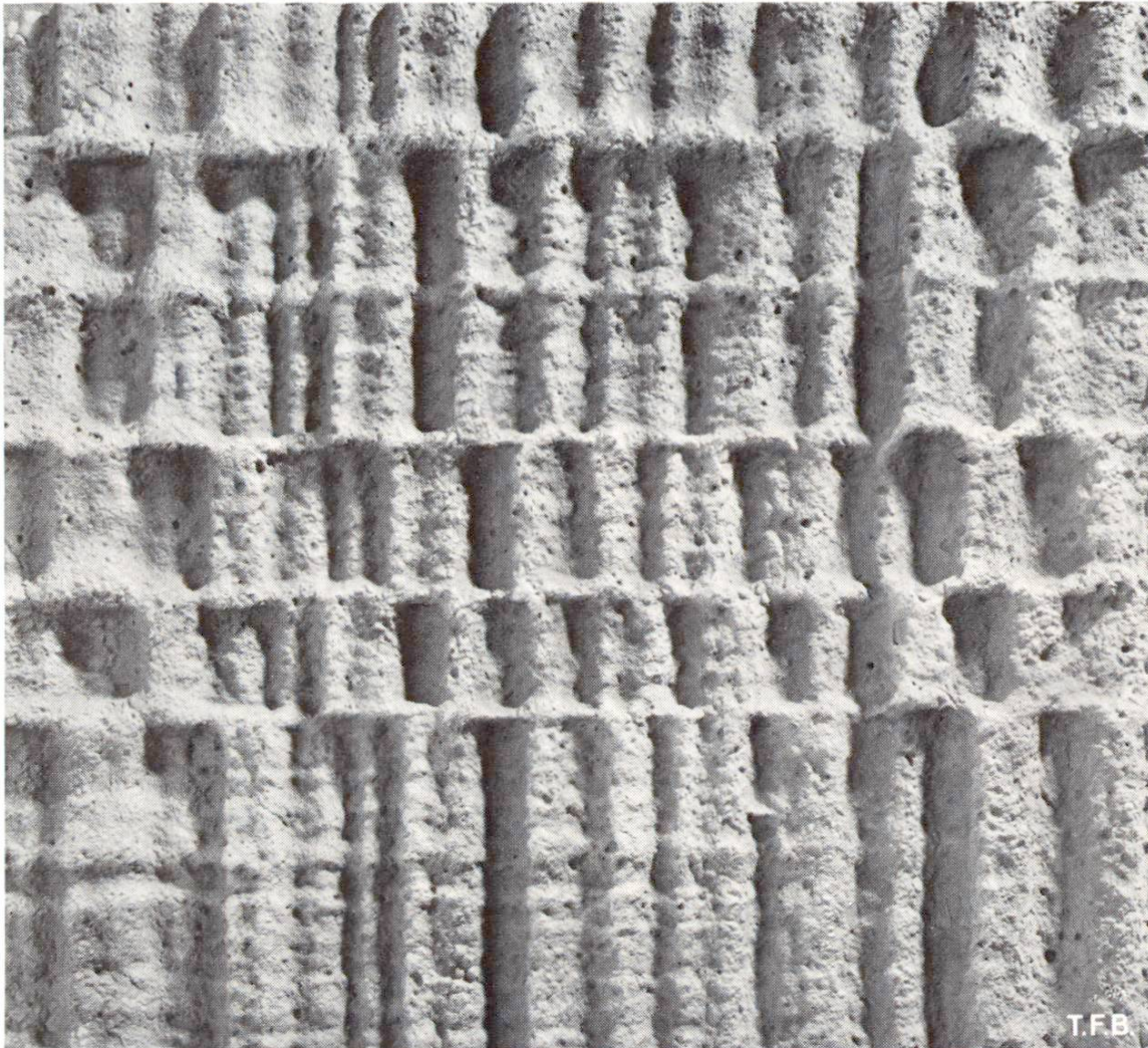
Abb. 6 Ornamentartige Zeichnung aus einer «Prewi»-Schalung. Sieben verschiedene Strukturen stehen zur Verfügung, weitere sind in Vorbereitung.
