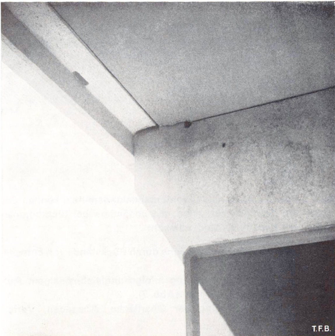
Abb. 6 Ungleichmässiger Auftrag von Schalungsöl auf Stahlschalung erzeugt Fleckenbildung.
