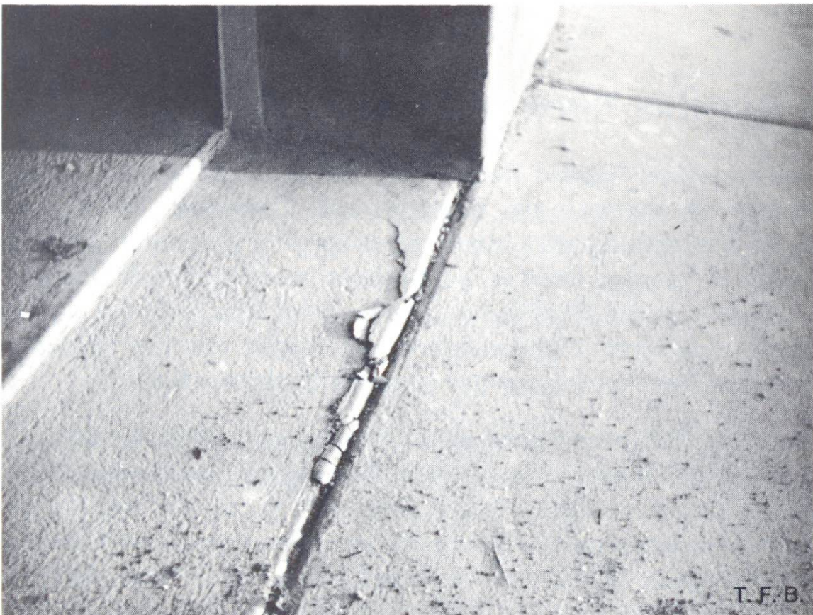
Abb. 4 Durch das Reiben der Kante, evtl. unter Besprengung mit zusätzlichem Wasser, ist der Beton stark geschwächt und Frostschäden vermehrt ausgesetzt.
