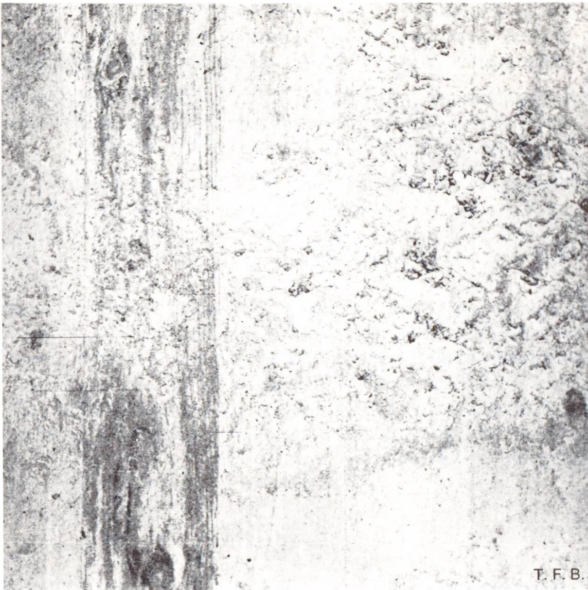
Abb. 3 Entmischung eines für guten Sichtbeton ungeeigneten Betons mit zu geringem Mörtelanteil. Man erkennt mangelhafte Verdichtung und verbleibende Hohlräume.
