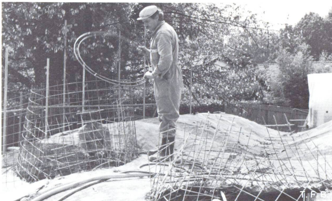
Abb. 6 Anschluss der Lichtkuppeln. Die erste Schicht wird aufgebrochen, die Armierung zum «Krater» geformt und mit einem Metallring als Aufsatz für die Lichtkuppel versehen. Dann werden die weiteren Spritzbetonschichten aufgetragen.
