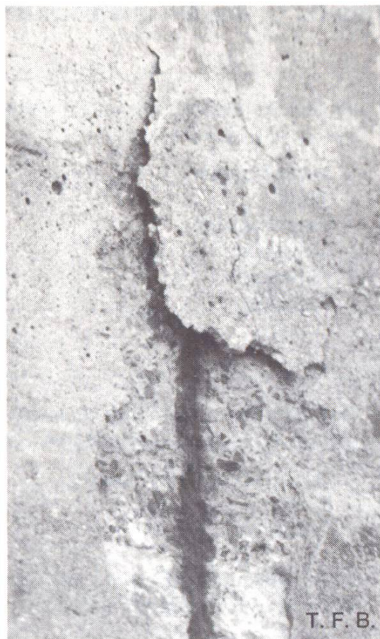
Abb. 5 Aufwölbung und Abplatzung infolge Korrosion der Armierung.
