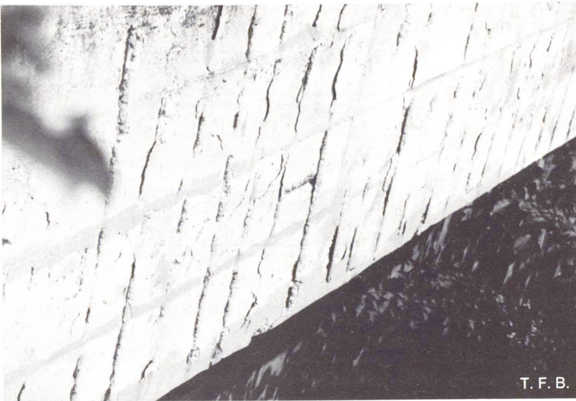
Abb. 6 Rostschäden an Balkonbrüstung infolge fortgeschrittener Karbonatisierung.
