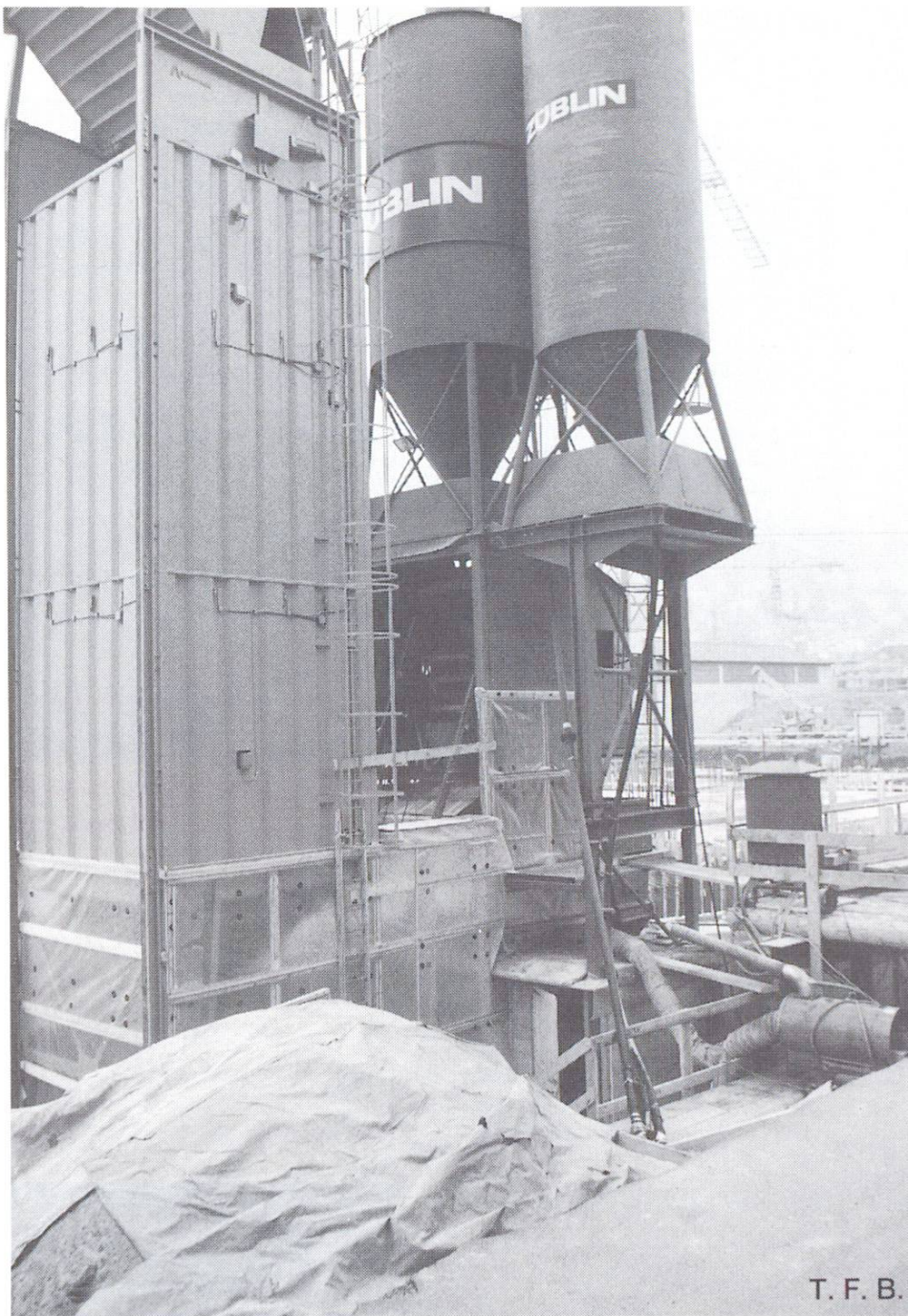
Abb. 2 Mobile Anlage, bestehend aus Kiessilo, Mischer, Zementsilo und Silo für Zusatzstoffe. Die Tanks mit den Zusatzmitteln sind in der Stahlkonstruktion unterhalb des Mixers aufgestellt.
