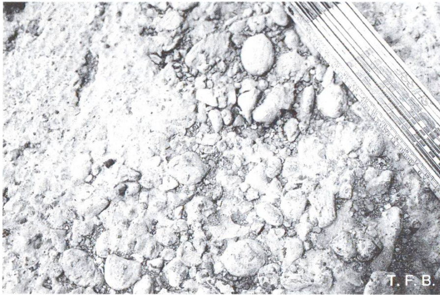
Abb. 4 Beispiel eines schlechten Untergrunds. Die losen Teile müssen erst noch entfernt werden.
