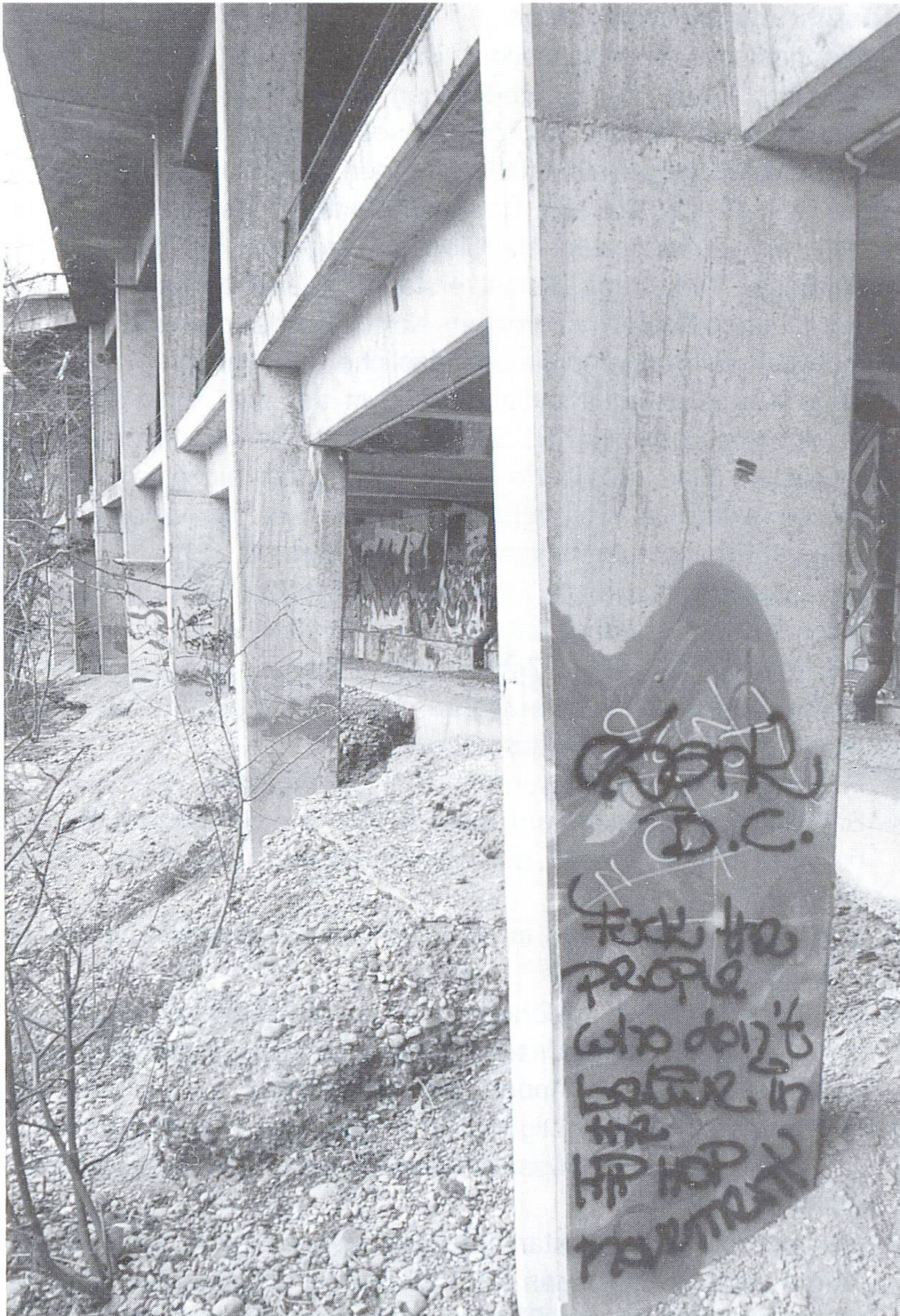
Unter dem Bahnhofplatz Baden: Durch undichte Stellen auf der Oberseite des mehrstöckigen Bauwerks drang chloridhaltiges Wasser ein, das in den abgebildeten Stützen zu starken Korrosionsschäden führte. Diese wurden durch kathodischen Korrosionsschutz ohne Veränderung der Tragwirkung der Stützen behoben (kein Beton entfernt). (Foto: Kurt Haberstich, TFB)
