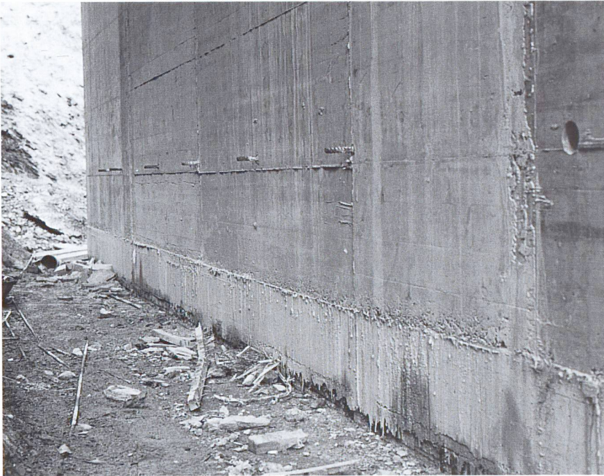
Wandstück aus Schwerbeton (hinten) und Normalbeton (Strahlenschutz-bunker für zwei Linearbeschleuniger, Kantonsspital Luzern) [9].
