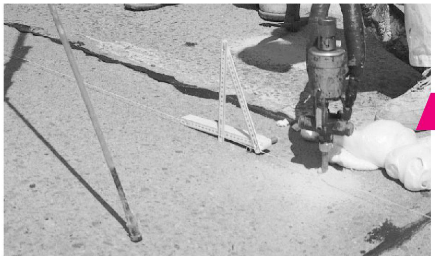
Vorbereitung zum Heben einer Platte durch Unterpressen (Kantonsstrasse im Tessin). Fotos: Rolf Werner, TFB
