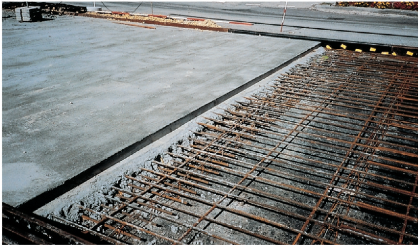
Arbeitsfuge eines durchgehend bewehrten Betonbelags (Le Locle, 1988).
