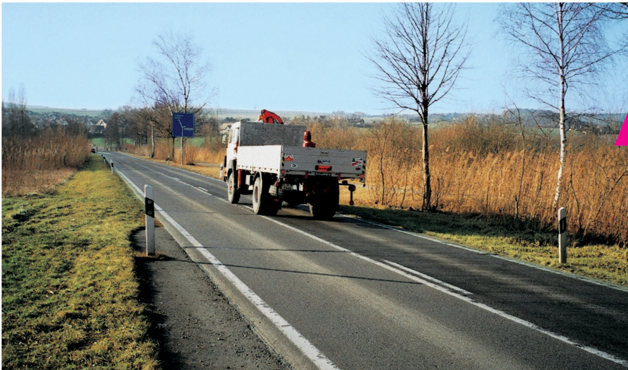
Kantonsstrasse Oberhöri-Dielsdorf (Neeracher Riedt). Die 1951 erstellte Strasse durchquert das Ried. Sie hebt und senkt sich je nach Höhe des Grundwasserspiegels um 1 bis 4 cm pro Jahr; Grundwasserstand: unterkant Betonbelag!
