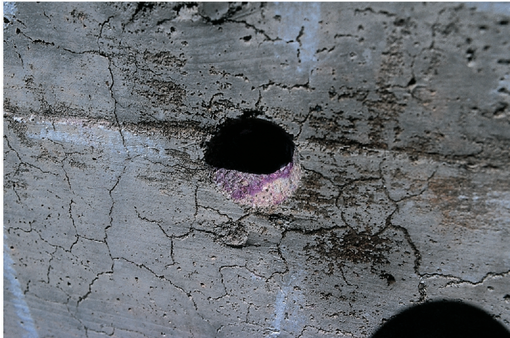
Rissursache: ungenügende Nachbehandlung.
