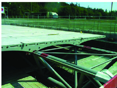
Abb. 1 In einem ersten Schritt wurden die vorgefertigten Betonelemente auf dem Stahlfachwerkträger abgelegt.
