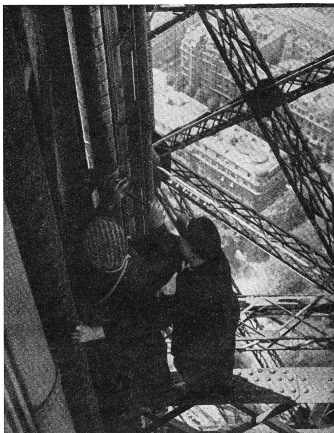
Fig. 2. Während der Montierung des Speisekabels der Antenne. Vue prise pendant le montage du câble d'alimentation de l'antenne.
