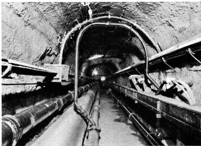
Fig. 7. Conduites industrielles posées dans une galerie
