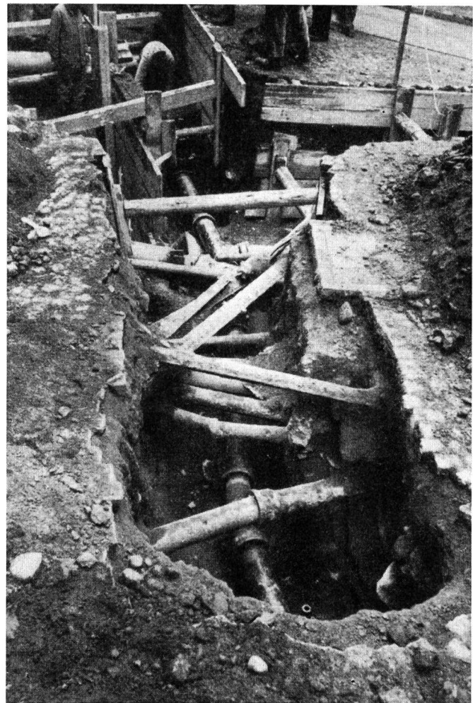
Fig. 6. Enchevêtrement de conduites industrielles
