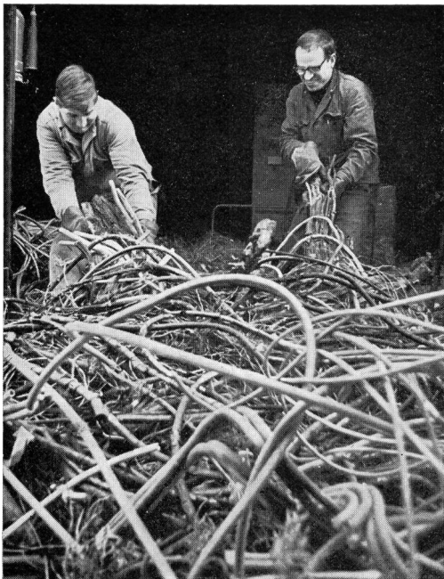
Fig. 5 Ausräumen beschädigter Kabel Enlèvement de câbles endommagés
