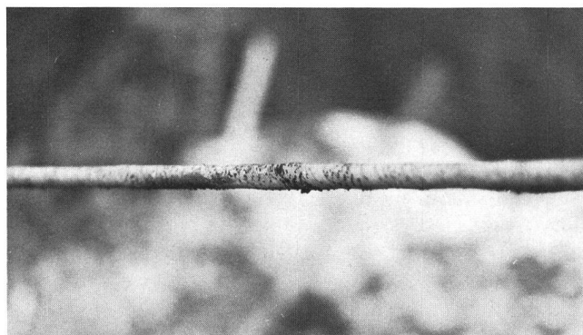
Fig. 11 Unter der hohen Flächenpressung der Armierungsdrähte entweicht ein Teil des Teers an die Kabeloberfläche – Sous l'effet de l'énorme pression de surface exercée par les fils de l'armure, une partie du goudron suinte à la surface du câble
