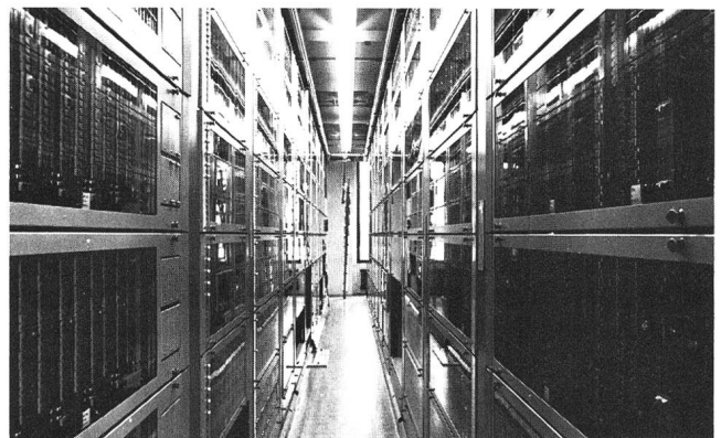
Fig. 2 Blick in die Gestellreihen der Relais und Wähleinrichtungen des neuen Fernamtes
