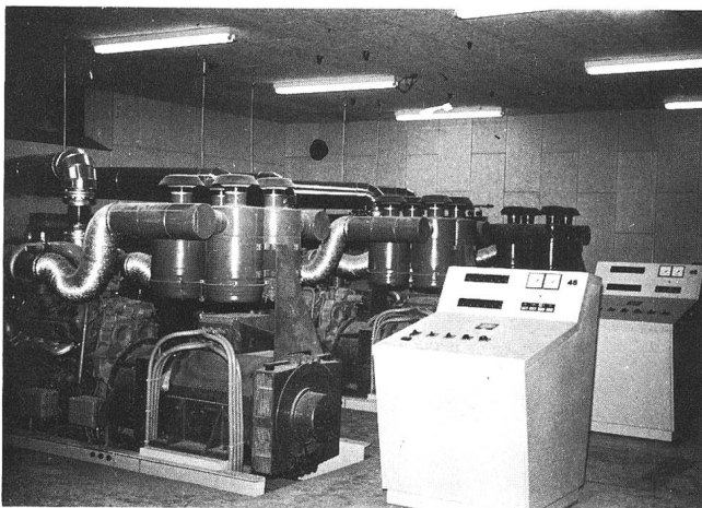
Fig. 13 Dieselraum der Notstromanlage Sântis – Local du groupe de secours au Sântis
