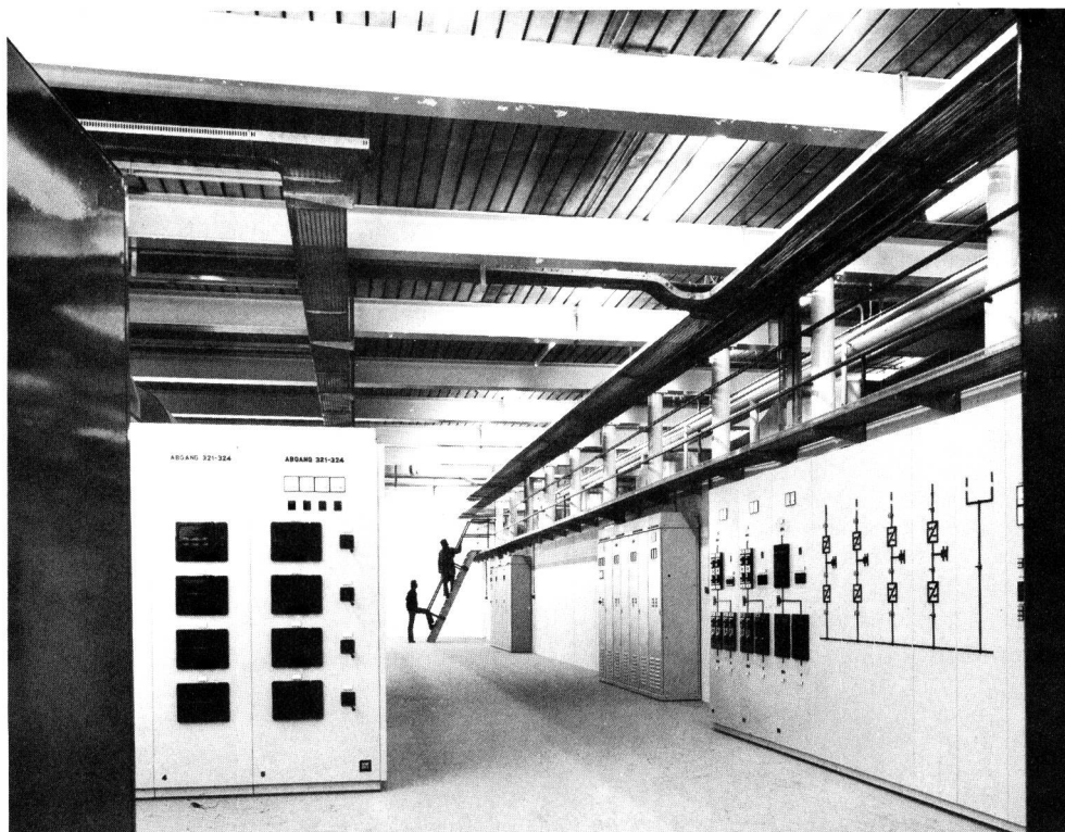
Fig. 57 Gleichrichter/Wechselrichter-Raum — Local des redresseurs et onduleurs
