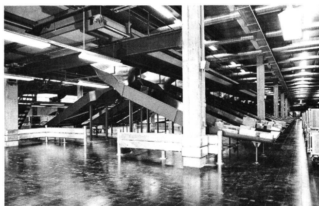
Fig. 15 Sortieranlage für die zentralisierte Paketzustellung der Städte Olten und Aarau – Installation de tri pour la distribution centralisée des colis à destination des villes d'Olten et d'Aarau
