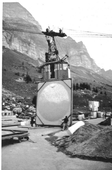
Fig. 4 Sondertransport von Kavernenabdeckungen nach der Höhenstation Sântis — Transport spécial de panneaux de protection d'antennes pour la station du Sântis
