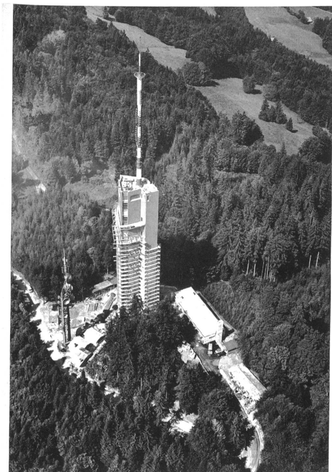
Fig. 3 Die Mehrzweckanlage auf dem Mont-Pèlerin gewährleistet unter anderem als Sender- und Richtstrahlstation die Verbindung mit dem Unterwallis — L'installation à usages multiples sur le Mont-Pèlerin assure, en tant que station émettrice et à faisceaux hertziens, la communication avec le Bas-Valais
