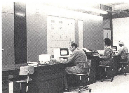
Zentraler Mess- und Prüfraum der Hauptzentrale
