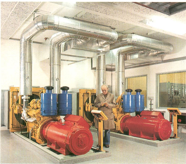
Notstromgruppen zu je 270 kW – Groupes de secours d'une puissance de 270 kW chacun
