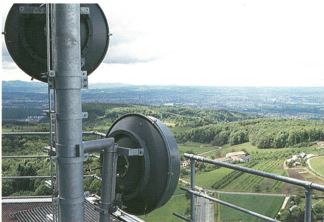
Parabolspiegel für Richtstrahlverbindungen auf einer Antennenterrasse – Paraboles pour liaisons par faisceaux hertziens sur une terrasse d'antennes
