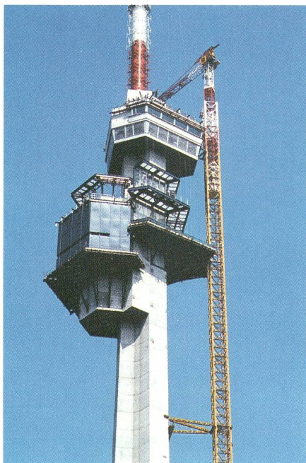
Bauzustand Februar 1983. Turmausbauten mit «blauem Rucksack», Antennenterrassen, Reportageraum und Arbeitsgerüst – Etat des travaux en février 1983. Eléments en saillie, terrasses d'antennes, local de reportage et échafaudages de travail
