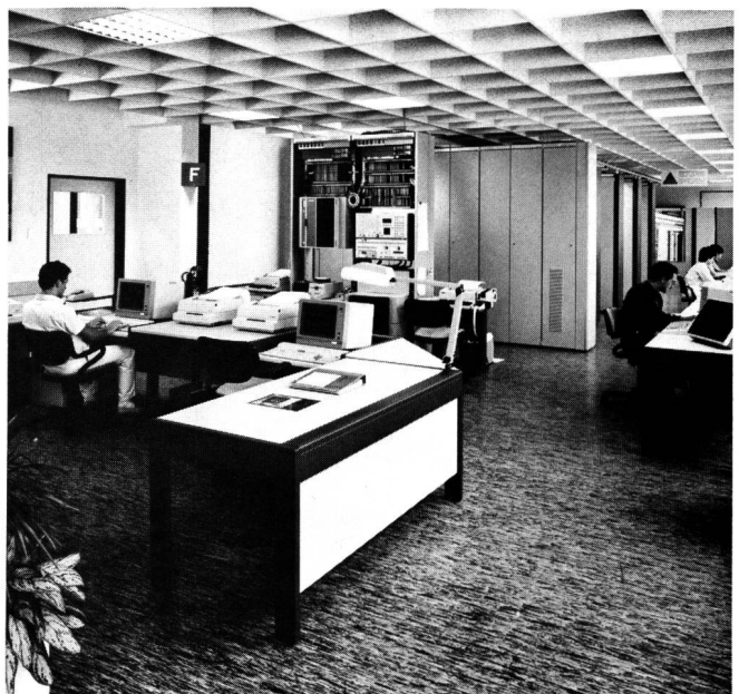
Fig. 10 Blick in die Testanlagen EWSD für die Integrationstests – Aperçu des installations d'essai EWSD servant aux tests d'intégration
